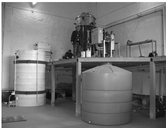
Цех очистки стоков на базе вакуумной выпарной установки Escorima 5000 - CR/WS . Слева танк для накопления обрабатываемых стоков, справа танк для дистиллята, г. Калуга.
